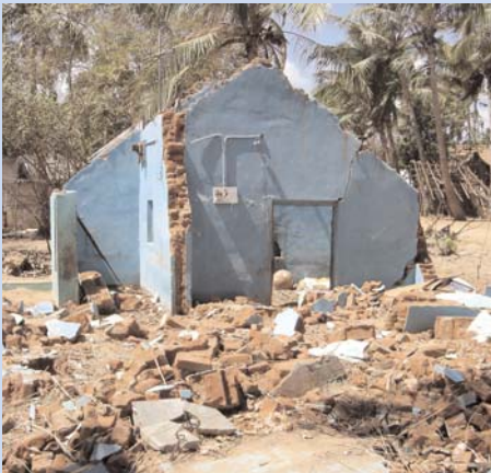
Dégâts occasionnés par le tsunami sur la côte est du Tamil Nadu
